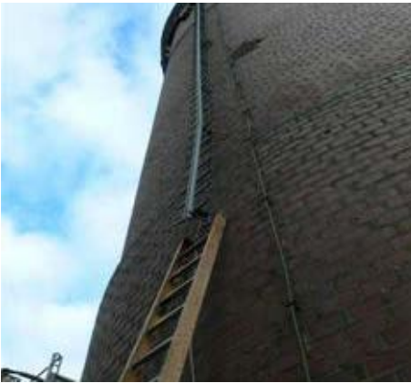
Abb. 13 Unsichere Zugangssituation bei Steigleitern an Schornsteinen
