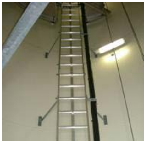
Abb. 21 Steigleiter in einer Windenergieanlage
