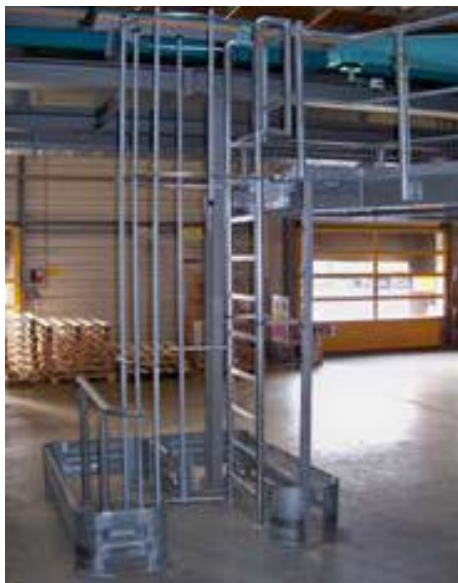
Abb. 20 Steigleiter als Zugang zu einer Maschinenarbeitsbühne
